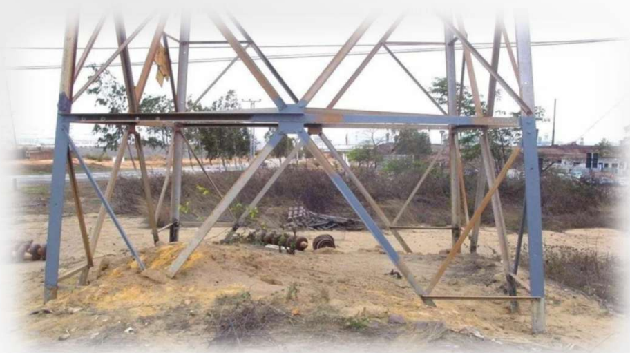
Estructuras de acero galvanizado
