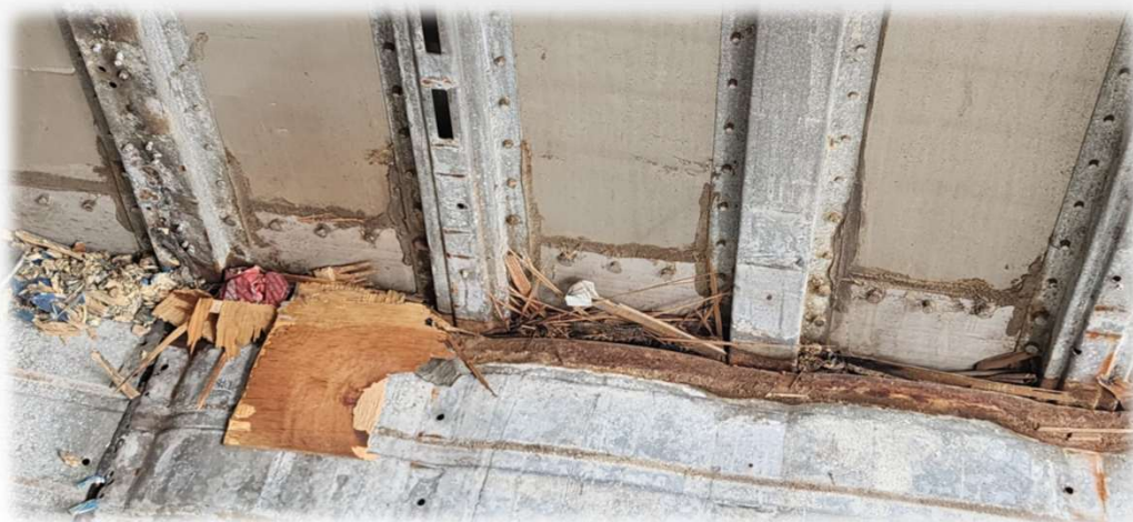
Acumulación de madera en el zoclo(genera oxido)
