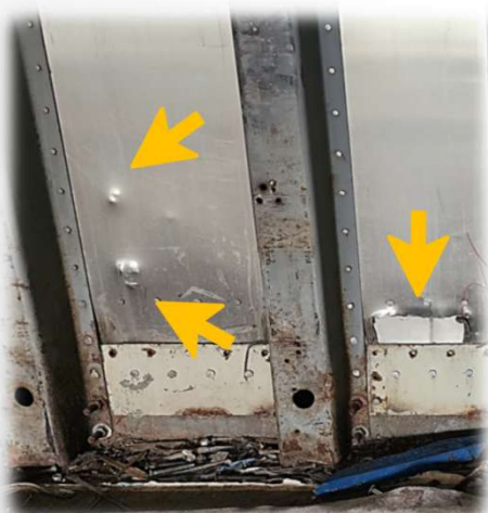
Impactos y rotura
