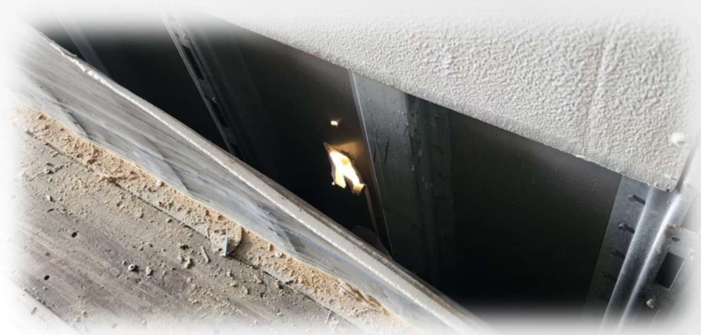
Impactos paneles laterales (desde el exterior)
